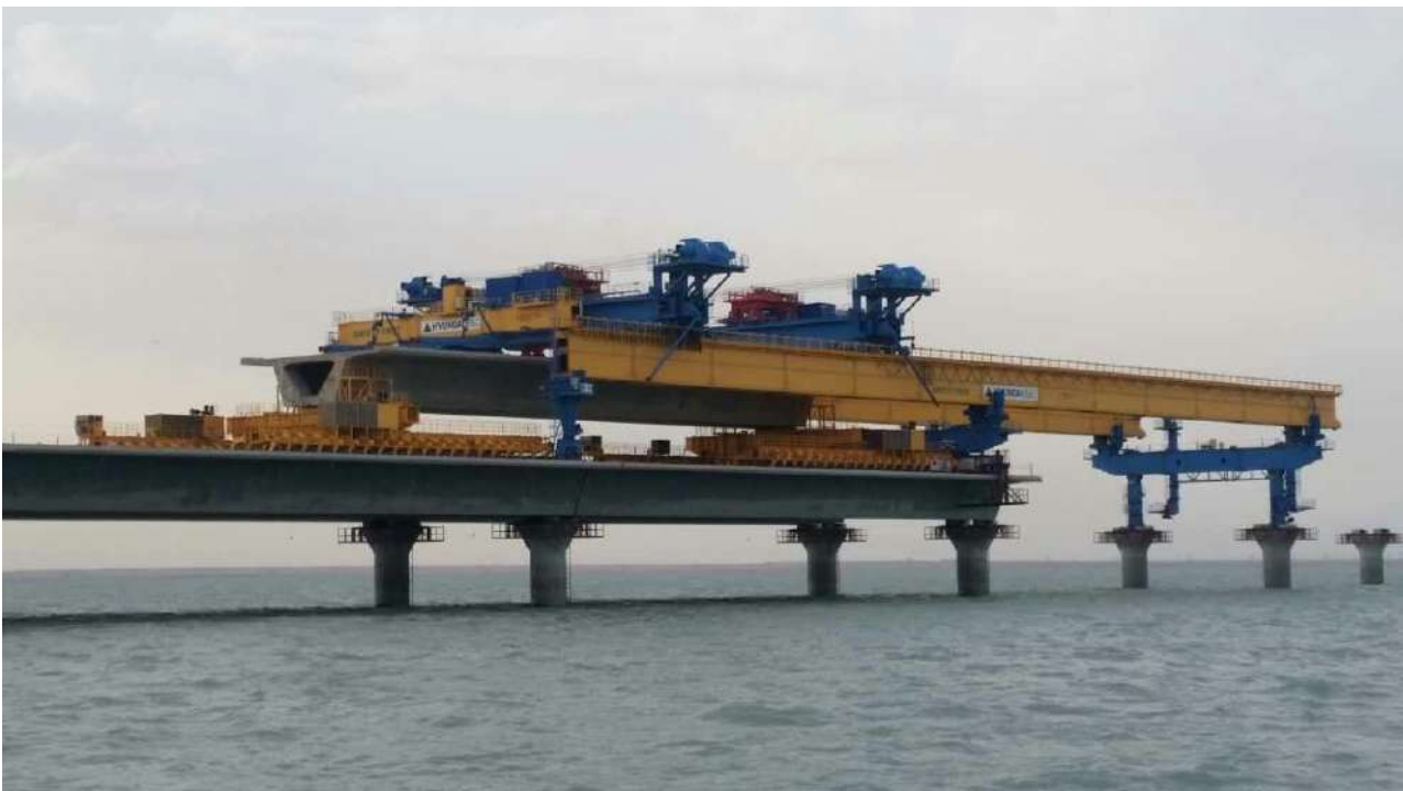
Figura 2. Lanzadera de vanos en posición para la colocación de un vano prefabricado
